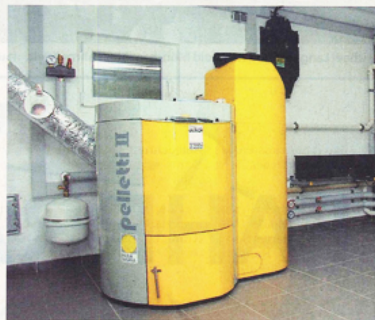
Eine moderne Pelletheizung.
